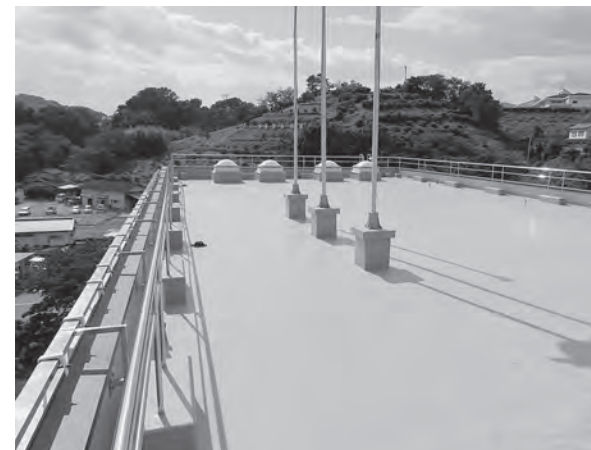
太陽光パネルが設置される庁舎屋上
