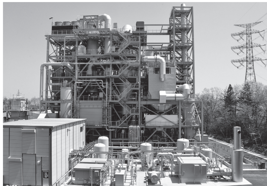
稼働した仮設減容化処理施設
