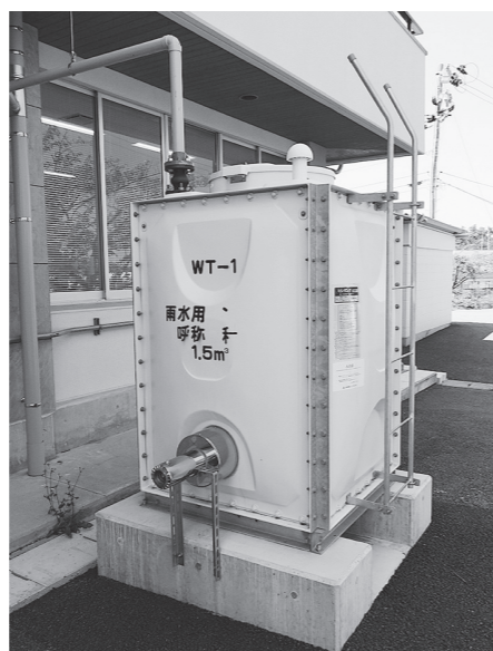
公民館に設置されている雨水貯留タンク
