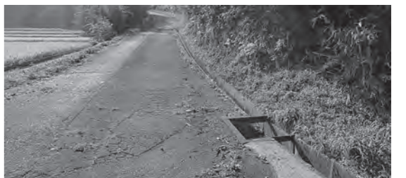
蓋のない道路側溝
