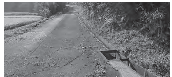
蓋のない道路側溝
