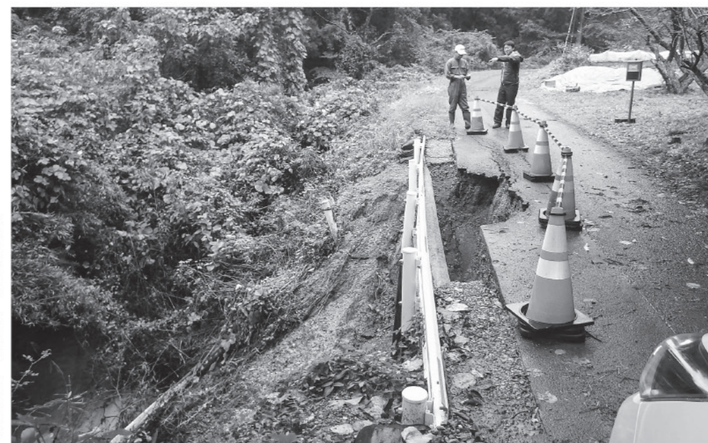
被害を受けた道路（上北町）
