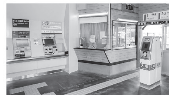
駅に設置された機器
